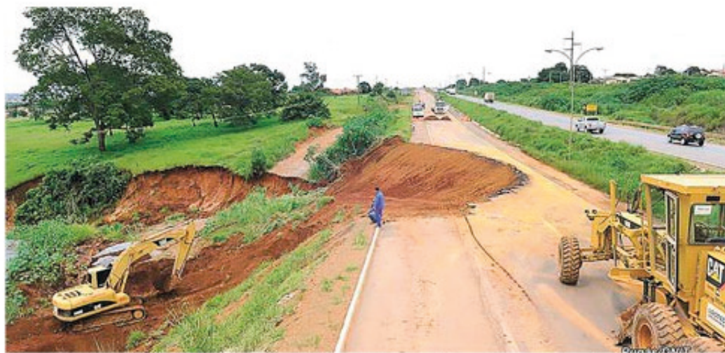
Erosão em Anápolis: município sofre com buracos que se espalham com passagem das eras geológicas. Ministro sugere estado de emergência para que governo federal apresse liberação de recursos
